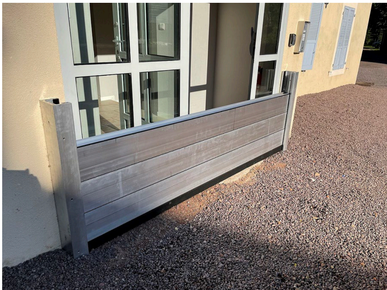
Pose d'un batardeau devant l'entrée d'un immeuble à Semur-en-Auxois (Yonne) © Even du fou (syndic de copropriété) 2022
